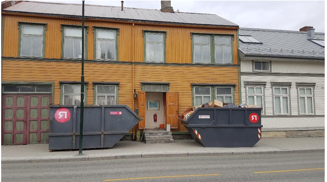
Figur 18: Container med pappesker og møbler plassert tett inntil fasaden. Bygget har luftet takfot.
