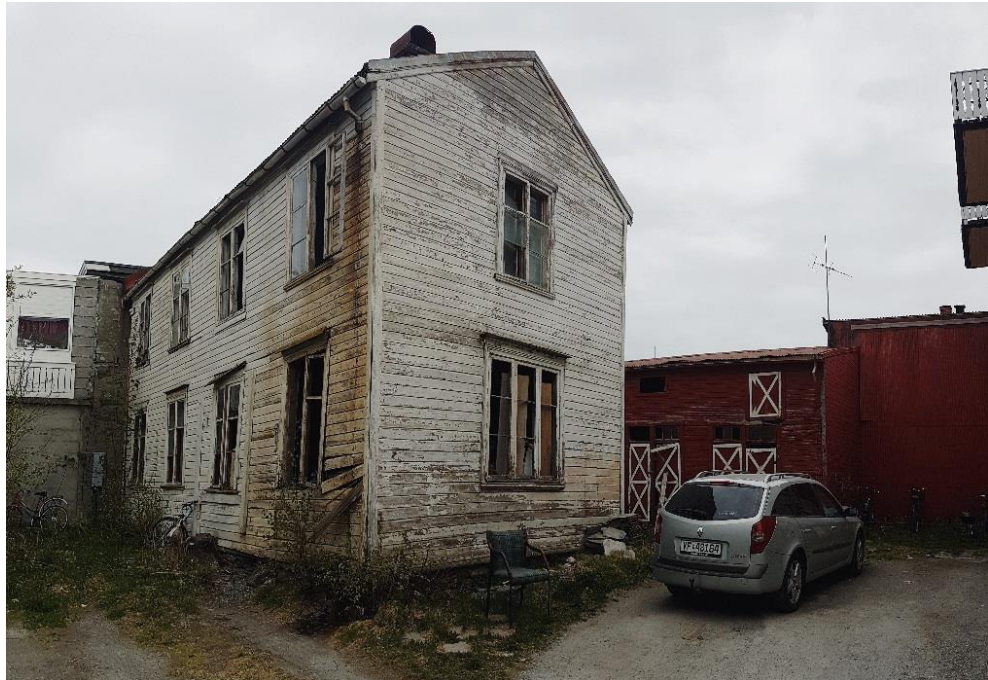
Figur 31: Utpreget eksempel på bygning med høy fare for brannspredning og som utgjør en fare for omkringliggende bygg.
